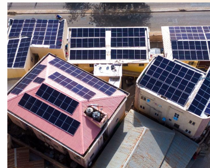
Nigeria G&I 120 kW
