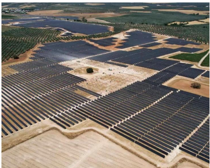
Spanien Versorgungsausmaß 175 MW
