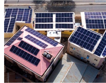
Nigeria G&I 120 kW
