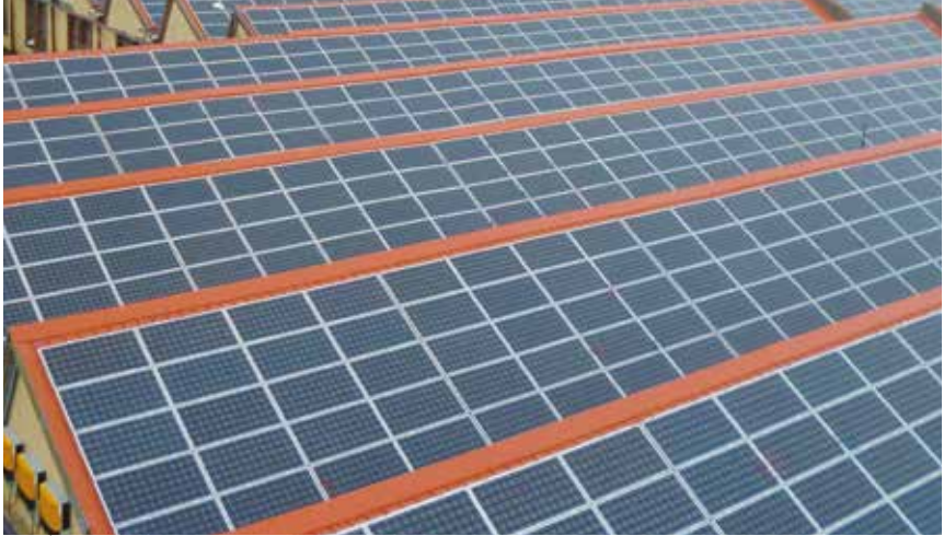
Cernay - Frankreich Anlage: 1,136 MW | SpeedRail mit AddOn
